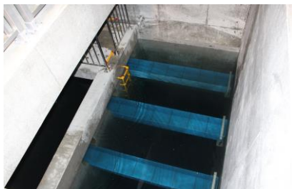
当別浄水場活性炭ろ過池
